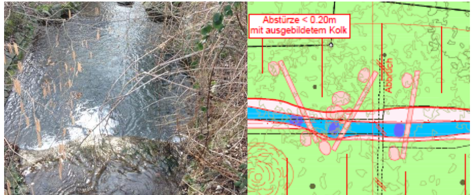
Abbildung 27 Absturz unterhalb Brücke Schwimmbadstrasse
