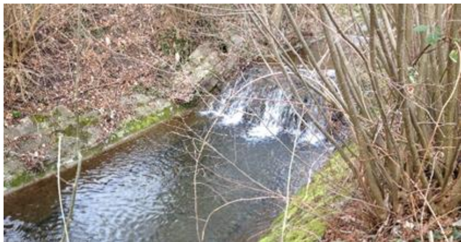
Abbildung 26 Absturz neben dem Feuerwehrgebäude
