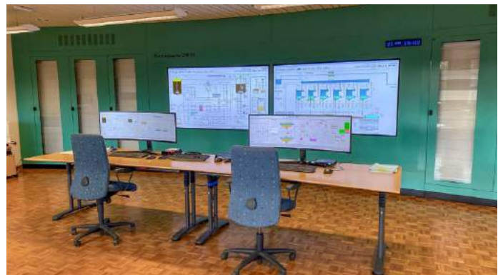
57 Zentrale Leitwarte ARA
