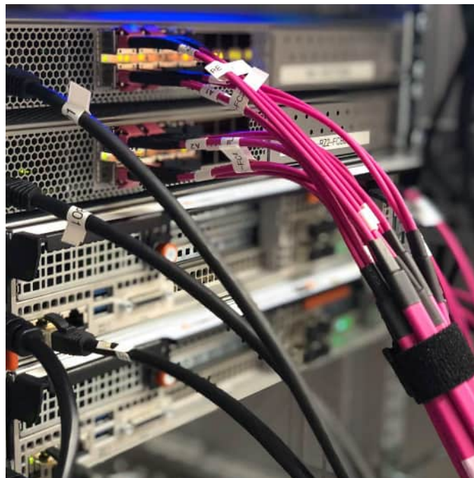
39 Server im Rechenzentrum
